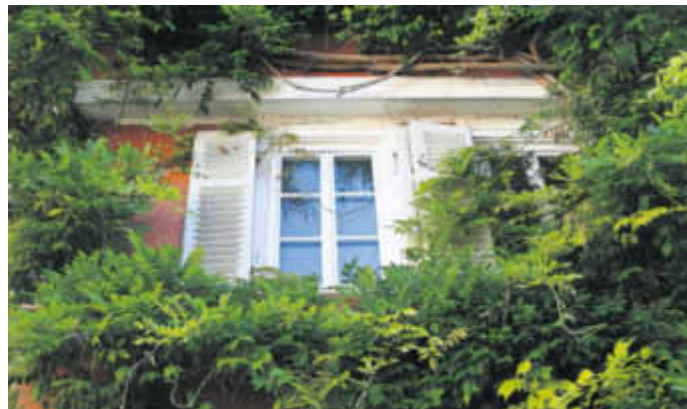
Auch eine Möglichkeit der Fassadendämmung – schön anzuschauen, aber wenig effektiv. Foto: Rainer Sturm/pixelio.de/Sto AG/akz-o
