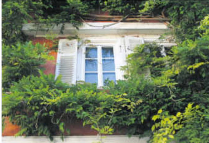
Auch eine Möglichkeit der Fassadendämmung – schön anzuschauen, aber wenig effektiv. Foto: Rainer Sturm/pixelio.de/Sto AG/akz-o
