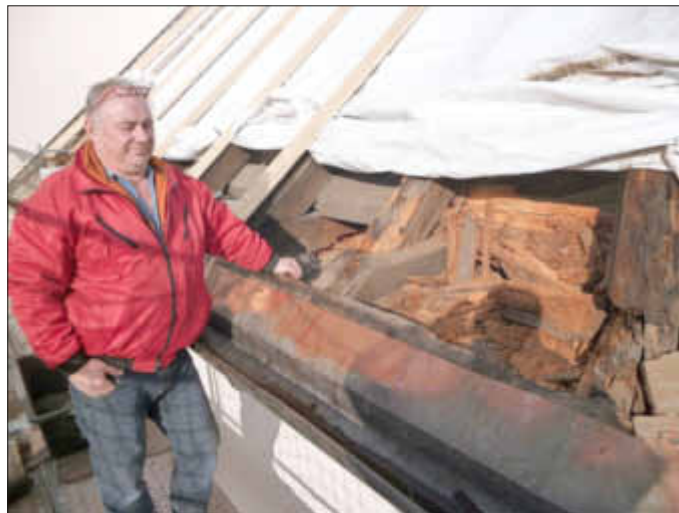
Zimmermann Michael Brandenburger begutachtet die maroden Dachstuhllemente
