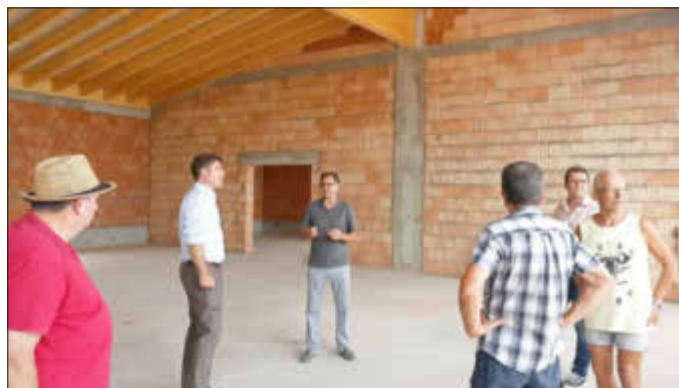
Im Neubau des Feuerwehrhauses
