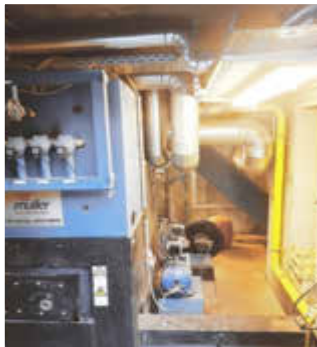
2022 - Heizungsanlage für Nahwärmespeicher
