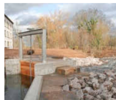
Fischtreppe Zeiskam Zeiskamer Mühle
