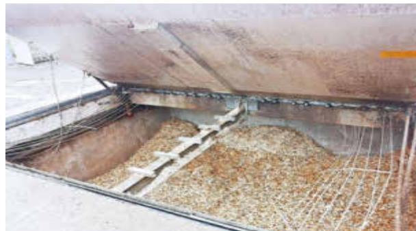
Holzhackschnittelspeicher für Nahwärmenetz
