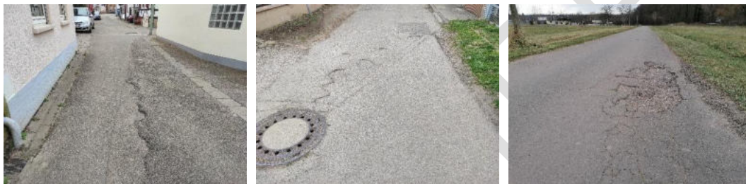
Abbildung 27: Straßenzustand Kirchstraße, Brühlweg, Zufahrtsstraße; eigene Aufnahme 2023
